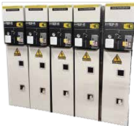
Celdas de media tensión SF6
